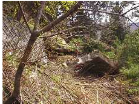
ブロック積の倒壊
