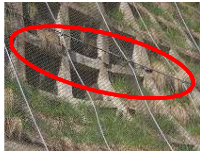
法枠に発生した亀裂
