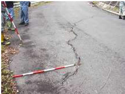
路面に発生した亀裂
